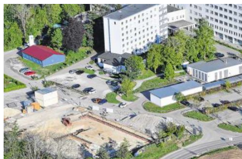
Die Verkehrssituation am Klinikum soll sich bald entspannen: Nahe des Gebäudekomplexes hat der Bau eines Parkhauses begonnen. Foto: Harald Langer
